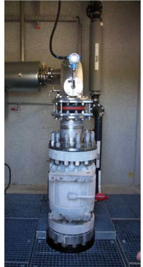
Förderbohrung: Hier kommt das heiße Wasser aus der Erde
